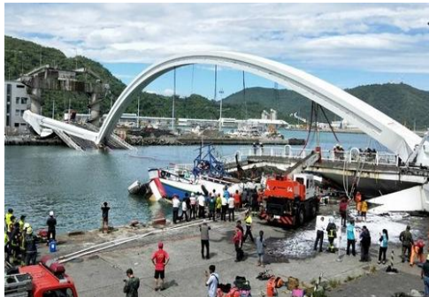
南方澳大橋斷裂
