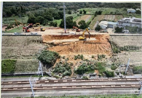
高鐵通霄段滑坡
