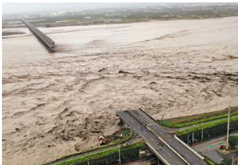
雙園大橋斷裂
