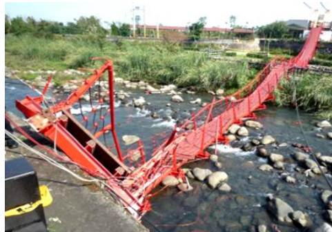
三芝吊橋斷裂
