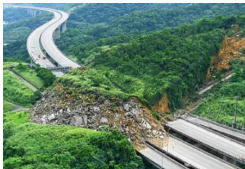
國道三號崩塌
