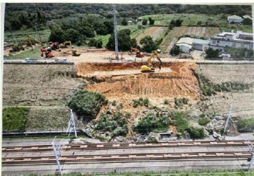
高鐵通霄段滑坡
