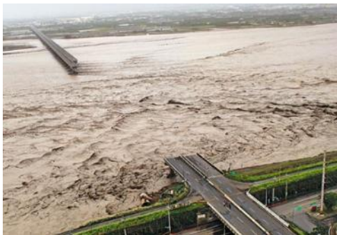
雙園大橋斷裂
