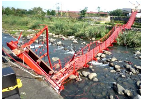
三芝吊橋斷裂
