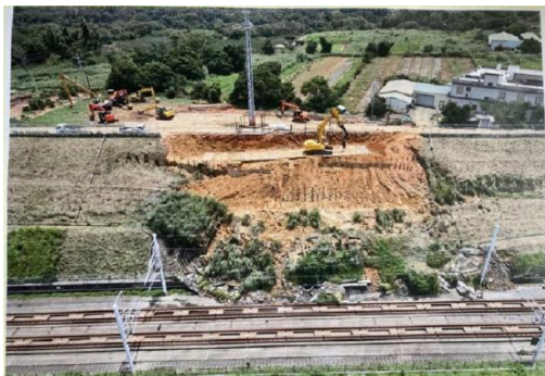
高鐵通霄段滑坡
