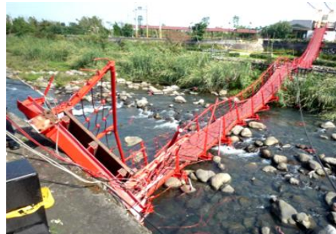
三芝吊橋斷裂
