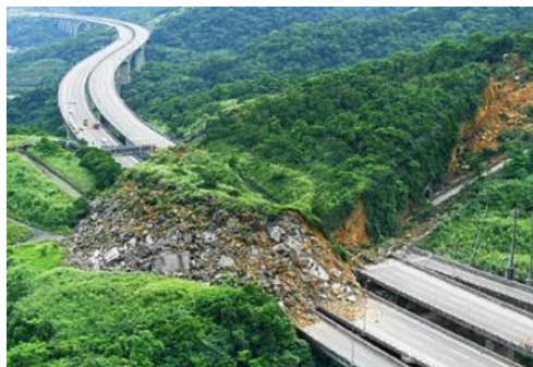
國道三號崩塌
