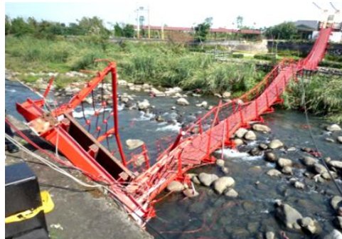
三芝吊橋斷裂
